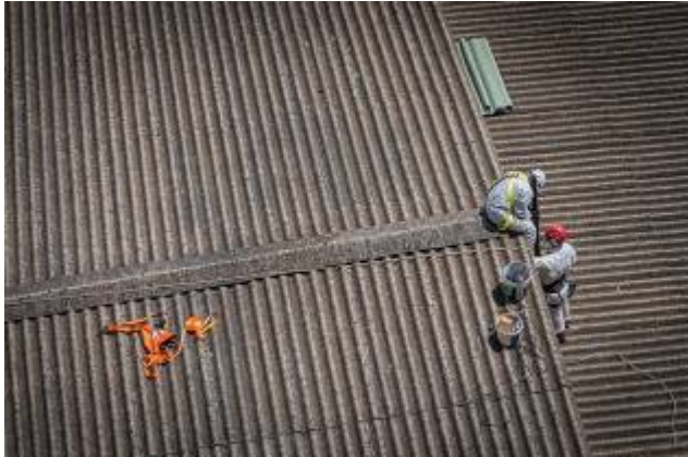
Coberta amb amiant a un edifici de Barcelona en una imatge d'arxiu / MANU MITRU
