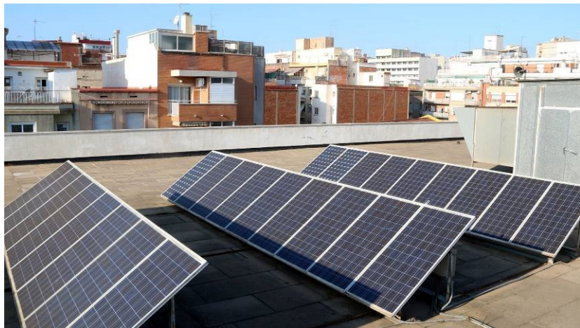
Imatge de plaques fotovoltaïques instal·lades a la coberta de La Farga de l'Hospitalet. ÀLEX RECOLONS / ACN
