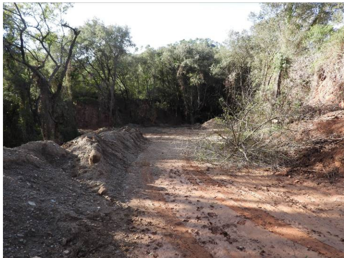
Aspecte del terraplè que obtura el torrent de la font del Safareiget, a mitjans d'octubre.
