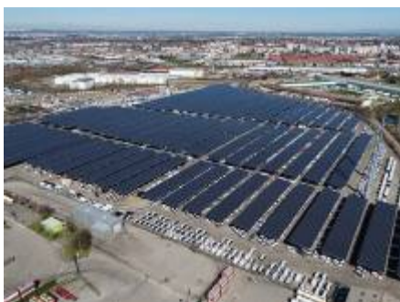
El 2019 es van cobrir amb marquesines solars 4.600 places d'un aparcament a Corbas, prop de Lió (Occitània).
