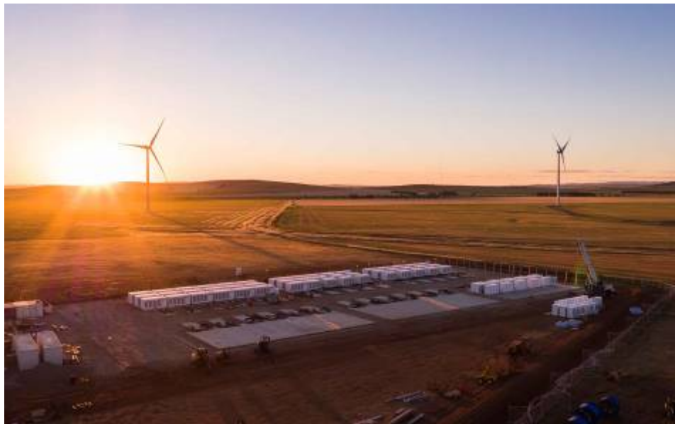
El 2017 va entrar en funcionament a Austràlia la bateria més gran del món en aquell moment, amb la funció també d'estabilitzar la xarxa elèctrica.
